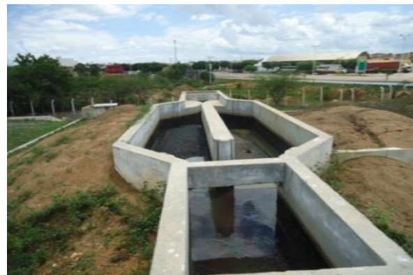
Figura 3: Tratamento preliminar da ETE.
