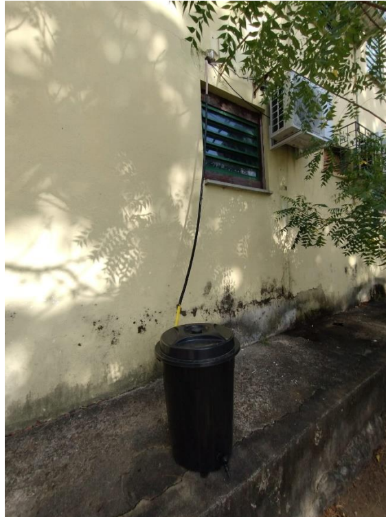
Figura 1: Reservatório de armazenamento de água residual de um aparelho de ar-condicionado. Sobral-Ceará. 2023.
